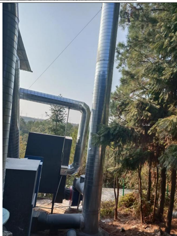
废气处理设施及排气筒
