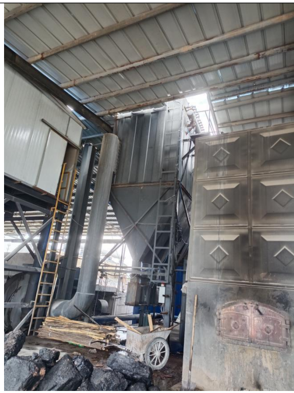
锅炉布袋除尘器
